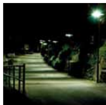
Gemeinde Emmingen, neue LED-Straßenleuchten
