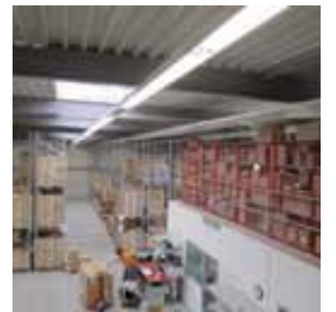
Lagerbeleuchtung mit LED-Lichtbandsystem
